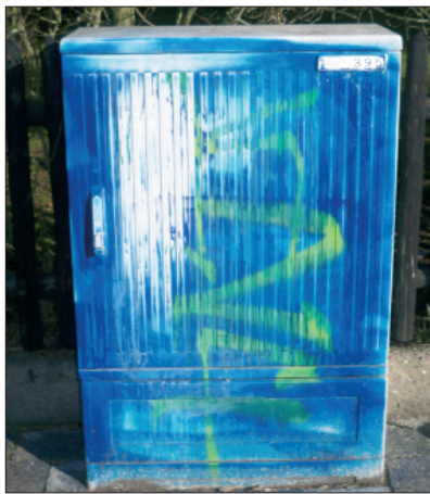
Bild 1: Mit Graffiti verschmutzter Kabelverteiler
