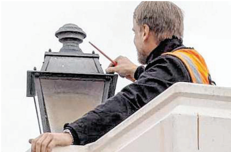
Die Straßenleuchten in Michelau werden auf die umweltfreundliche und sparsame LED-Technik umgestellt.
